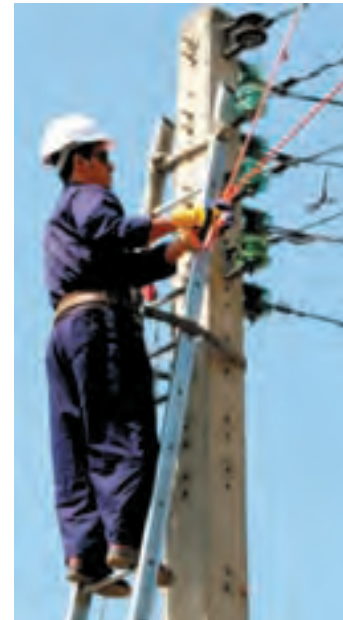
L'électrification, un soutien au développement.
