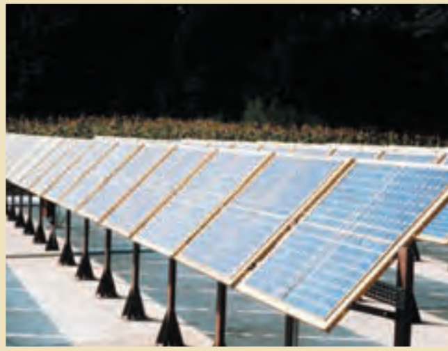
Panneaux photovoltaïques pour la production d'électricité.
